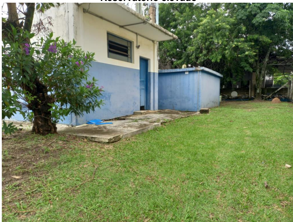
Casa de bomba e Reservatório Apoiado ao fundo
