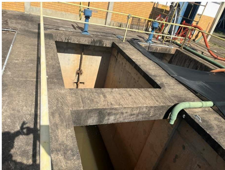
Foto 3 - Estação Elevatório de Água – Visita dia 03/05/22
