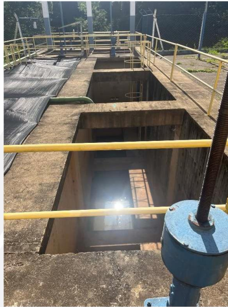
Foto 1 - Estação Elevatório de Água – Visita dia 03/05/22
