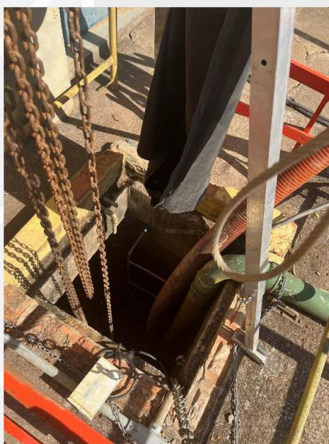
Foto 4 - Estação Elevatório de Água – Visita dia 03/05/22
