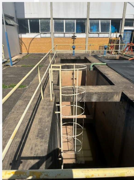
Foto 2 - Estação Elevatório de Água – Visita dia 03/05/22
